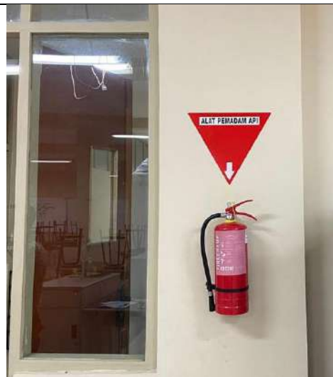
2. Fire Hydrant (Insitut Teknologi Nasional Bandung, Indonesia)
