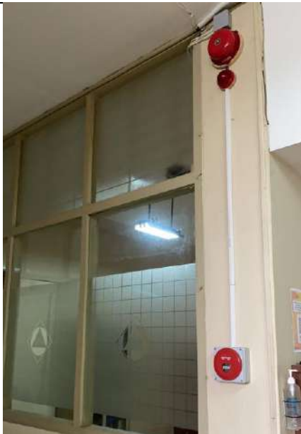
3. Fire Alarm System (Insitut Teknologi Nasional Bandung, Indonesia)
