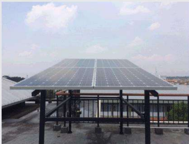
Instalasi PLTS 1000 Wp di Itenas
